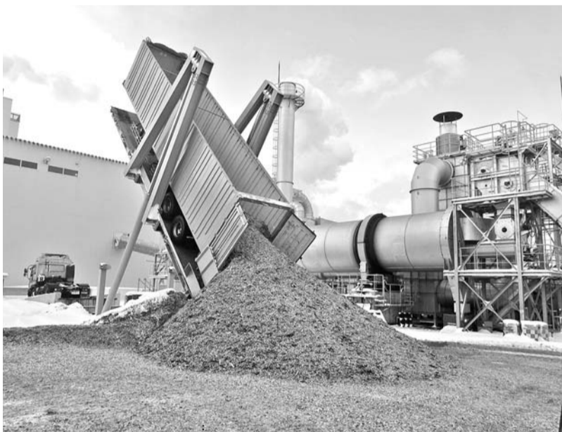
秋田県産の未利用材を原料の約7割使用して発電している
